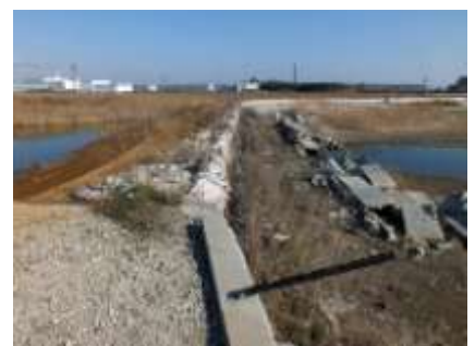
倒壊の方向と手すりの倒れた方向 手前と奥では逆方向に倒れている。
