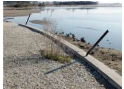
草が生えている場所 堤防に亀裂が入ると水が通るため草が生える。逆に草があれば堤防に亀裂がある可能性が高い。ここも裏側に亀裂があった。
